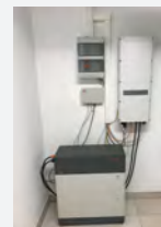
Platzbedarf für Wechselrichter und Speicherbatterie
